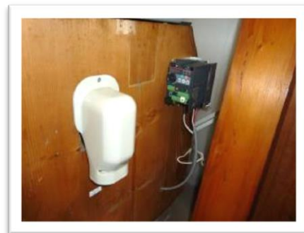
インバータが付いたブロワーボックス
